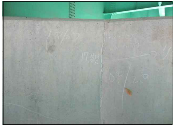
교각 코핑부 균열(P2)
