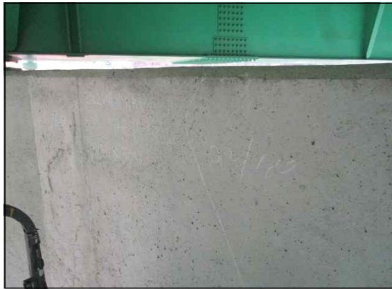
교각 코핑부 균열(P1)
