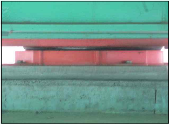
고무재 탈락(P1 SH1)
